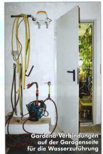
Die im Text beschriebene Mischbatterie
